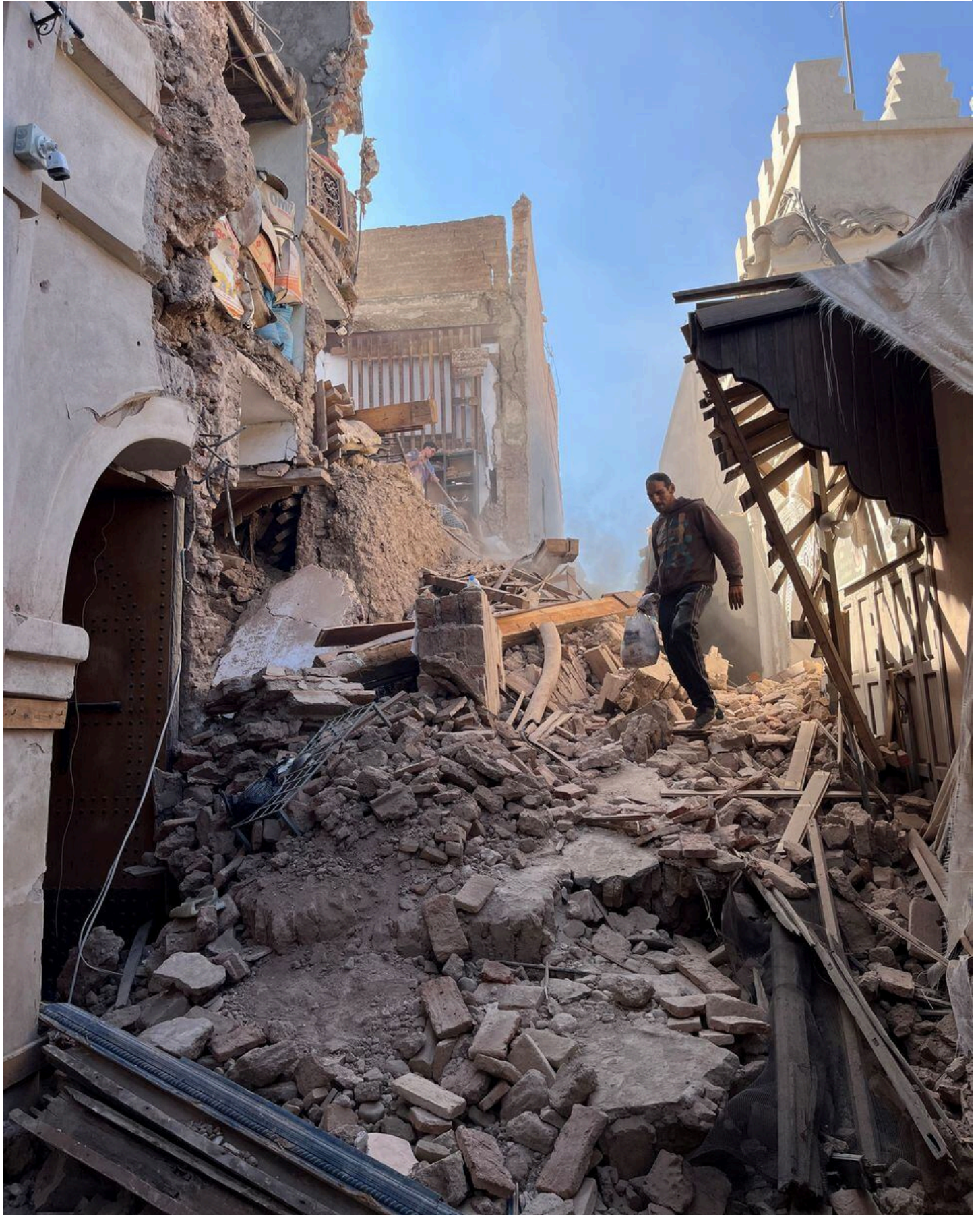
34. Un vecino camina entre los escombros de varios edificios colapsados en el centro de Marrakech.
